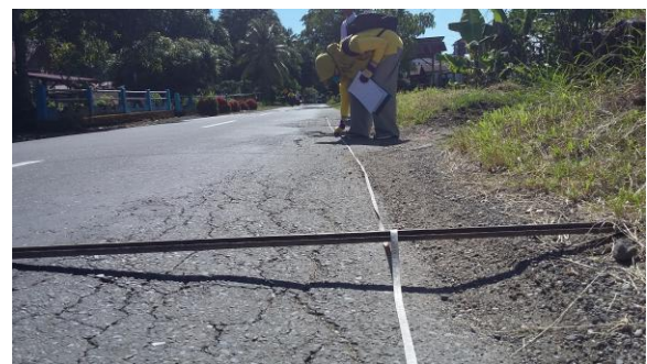
Gambar 4.11 Jalan rusak pada STA 3+700
