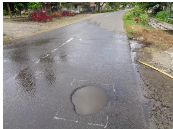
Gambar 4.10 Genangan air dan lubang pada STA 4+250
