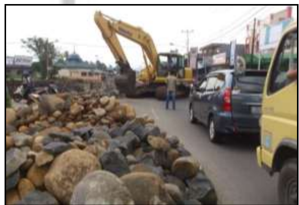
Gambar 20: Dampak kemacetan akibat aktivitas pekerjaan
