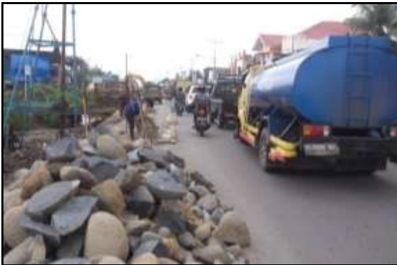
Gambar 22: Dampak kemacetan akibat tumpukan material
