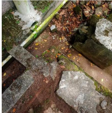
Gambar 1. Kondisi Drainase Universitas Andalas
